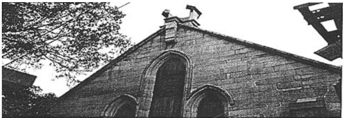
图4-9 石厝堂屋顶被破坏的钟阁
