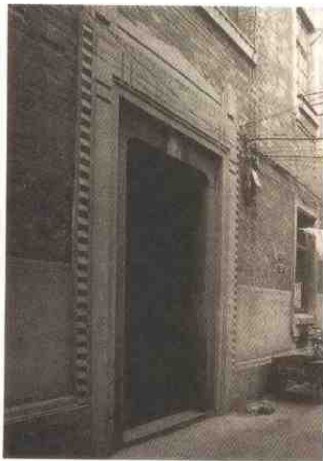
图 5-4-13 上海慈溪路 180 弄石库门，几何体块造型颇具新意。照片由作者摄于 1995 年。
