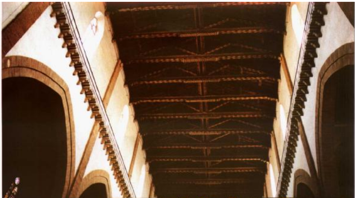
L10-04 圣克罗齐大教堂主堂木屋顶，既有装饰感，又显示了结构的明晰性和逻辑性
